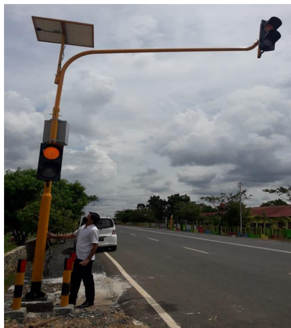
Pemasangan dan pemeliharaan trafict light
